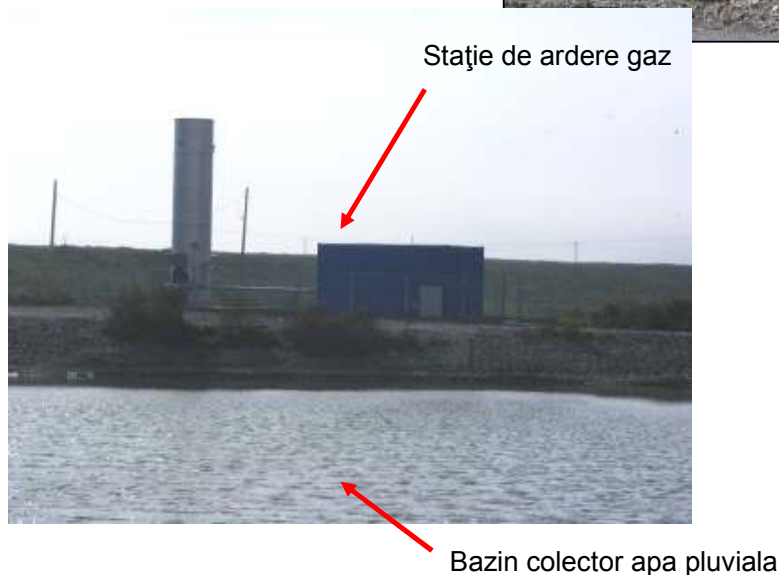
Figură 3. Stație de ardere gaz
