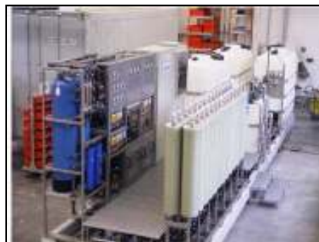
Figura 16. Instalație de tratare a levigatului prin osmoza inversă, montată într-o construcție tip container
